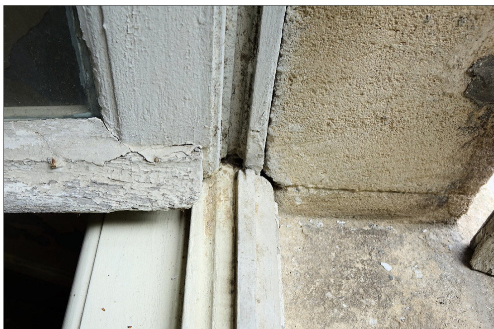
Fig. E.7. Pièce d'appui et appui en pierre d'une fenêtre de l'étage
