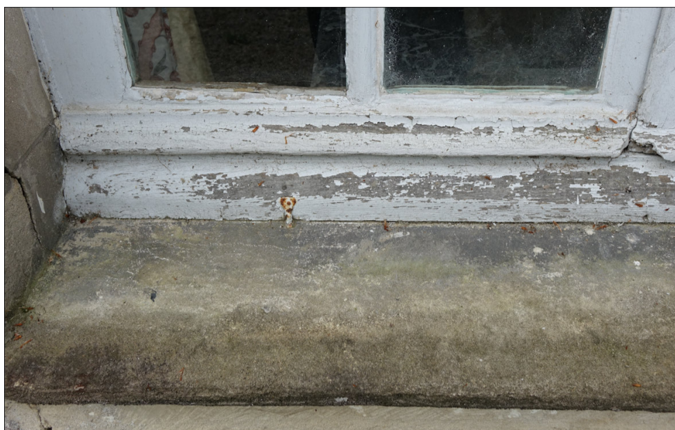
Fig. E.8. Pièce d'appui et appui en pierre d'une fenêtre du rez-de-chaussée.
