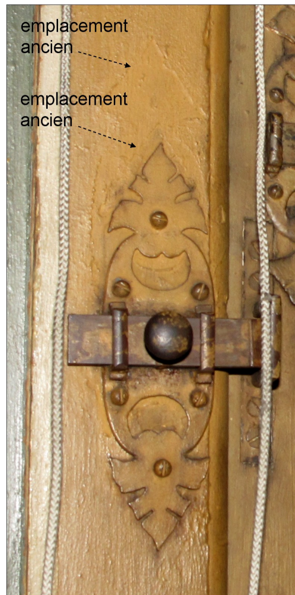
Fig. E.3. Château de Vaux-le-Vicomte. Croisée RdC 38. La peinture révèle deux anciens emplacements sous la targette
