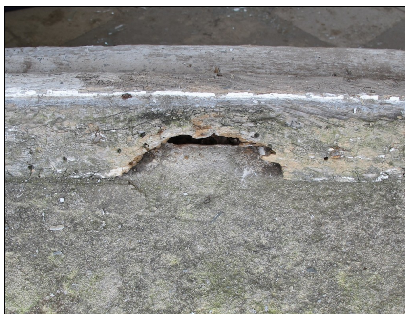
Fig. E.6. La pièce d'appui en bois, usée, laisse apparaître la simple feuillure de l'appui en pierre (vue depuis l'extérieur).
