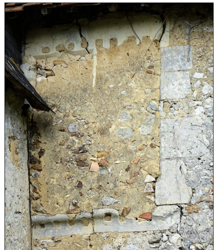
Fig. E.1 – Croisée murée et masquée en partie par l'escalier hors-œuvre ajouté.
